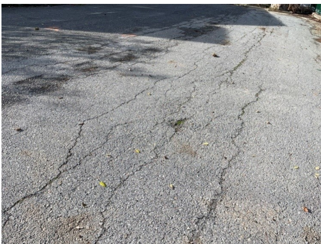
Εικόνα 7: Άποψη 1ου Δημοτικού σχολείου Ανωγείων-ρωγμές στην επιφάνεια γηπέδου
